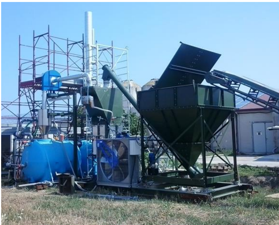
Il prototipo di CHIMERA installato presso l'azienda avicola F.Ili Lorenzetti
